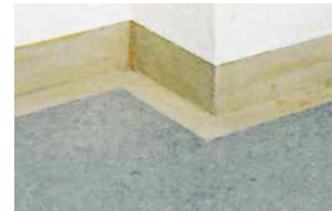
Bodenbelag mit Abstand zu den Wandflächen komplett verklebt.
